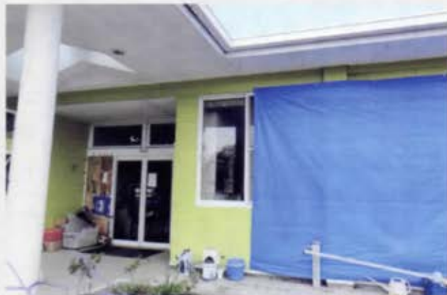
学生が片付けなどを行った福祉施設。外観からはわからないが、内部は大きな被害を受けた。
