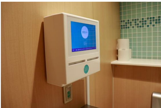
本学5号館に設置された OiTr(オイテル) 機器
